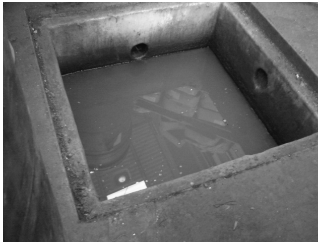
Figura 3. Caja de paso, aguas procedentes de Enjuague 2
